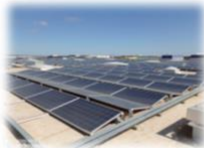
Placas fotovoltaicas Zaragoza
