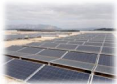
Placas fotovoltaicas Masquefa
